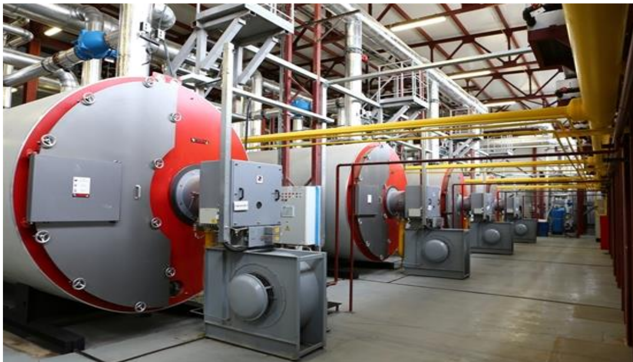
Котлы мощностью 40 МВт
