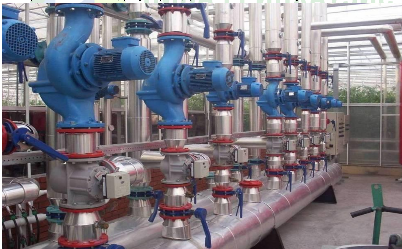
Коллектор системы распределения отопления
